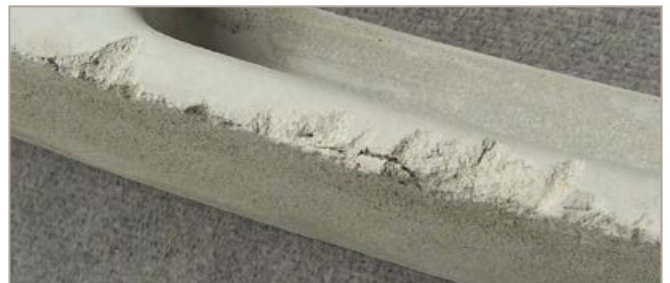
Abb. 43: Beispiel oberflächliche Abplatzungen
