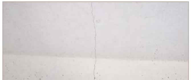
Abb. 44: Beispiel oberflächlicher Riss
