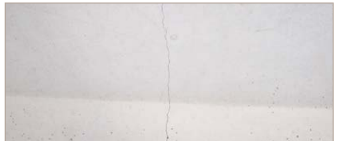
Abb. 71: Beispiel oberflächlicher Riss
