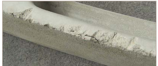
Abb. 70: Beispiel oberflächliche Abplatzungen
